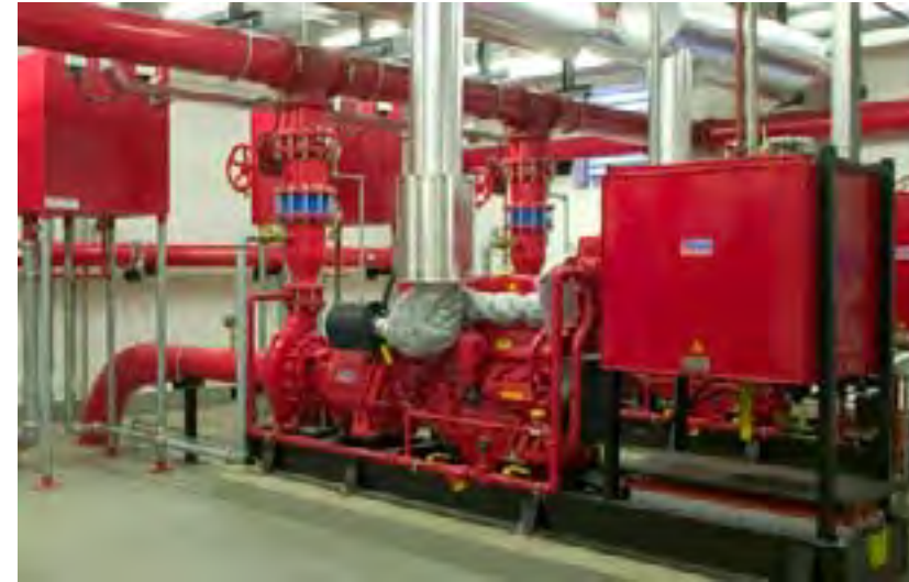
ตัวอย่างพื้นที่หัวเครื่องสูบน้ำดับเพลิงถือว่าเป็นส่วนที่สำคัญที่สุดขณะเกิดเหตุเพลิงไหม้ หัวด้านซ้ายกว้างขวางเข้าถ้งง่าย ขณะที่หัวด้านขวาพื้นที่เข้าบำรุงรักษาแทบไม่มี ทำให้ขาดการบำรุงรักษา และไม่สามารถใช้งานได้
